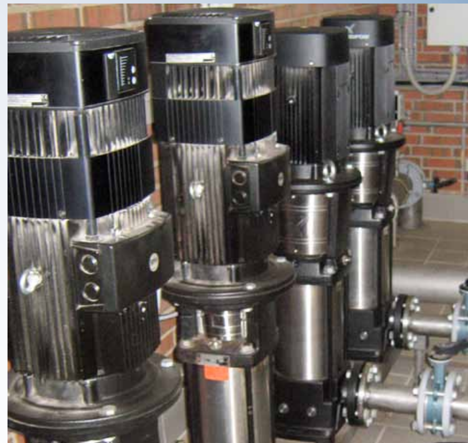
Rødkærsbro Vandværks nuværende pumpeanlæg
